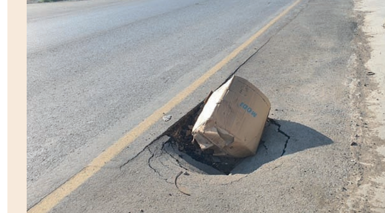
■ حفر وتشققات كثيرة في الطرق تشكل خطورة على مرطادي الطريق
